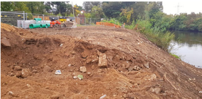
Erhöhter Anteil an Bauschutt in der Auffüllung [Randbereich Regnitz]
