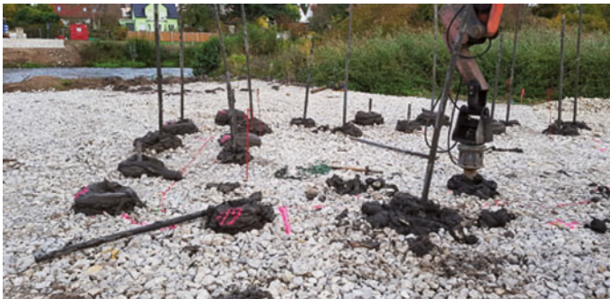
Bereich West: Bohrungen Kampfmittel bis ca. 6 m Tiefe, gefördert Material im oberen Bereich: Ton
