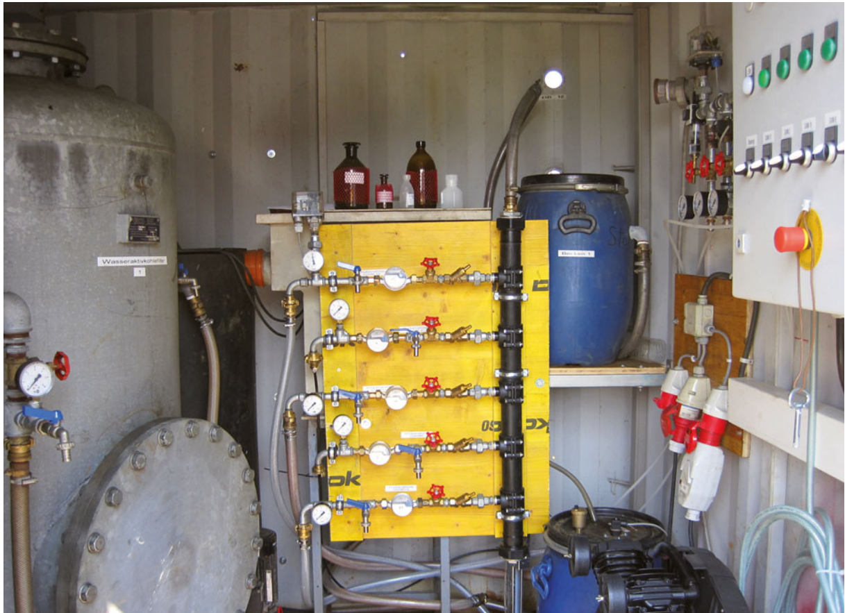
Sanierungsanlage in Container
